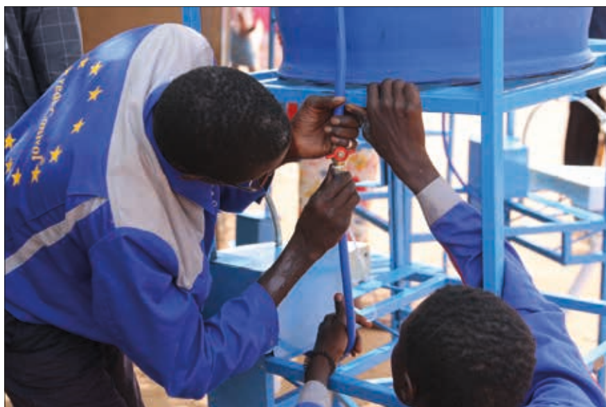
Installation d'un lavabo côté débarquement du poisson à Brufut, Gambie, Ngenarr-Yassin Jeng, Brufut, Gambie
